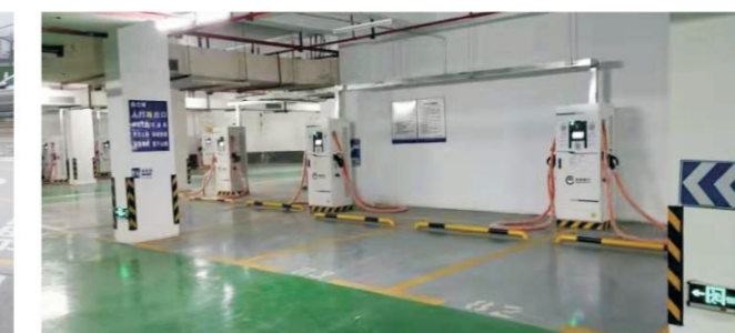
▲ 杭州成明（中能）快充站
