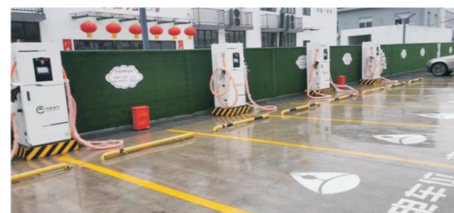
▲ 杭州啦喜街快充站
